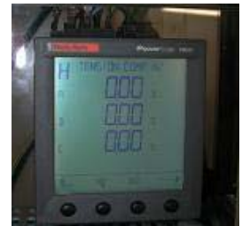
Face avant de la centrale de mesure à affichage digital
